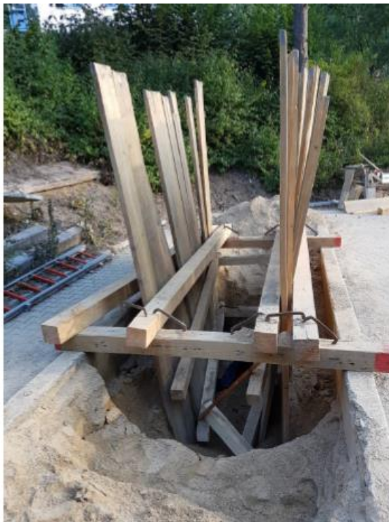
Abb. 1: Einsturz einer verbauten Baugrube
