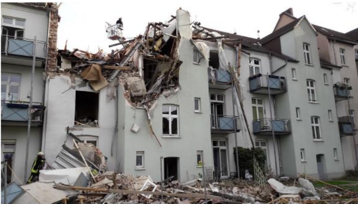
Abb. 1: Gebäudeeinsturz nach Gasexplosion, Quelle: Herr Pletscher (HLFS)
